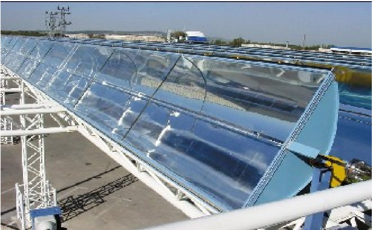
624 espelhos refletores - convergem os raios solares em um ponto da torre
