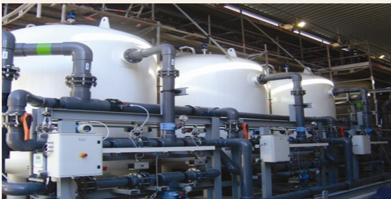
Osmose reversa – Estação de dessalinização da água – África do Norte
